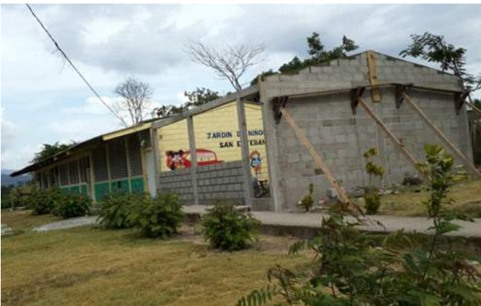
DONATIVO ECONOMICO PARA LA COMPRA DE CEMENTO A LA ESCUELA MATIAS FUNEZ DE LA COMUNIDAD DE CONQUIRE SAN ESTEBAN PARA CONSTRUCCION DE 1 AULA.
